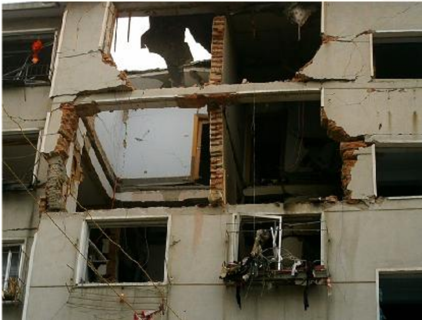
营口居民楼煤气爆炸
